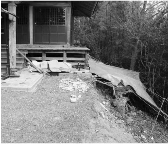
社殿南側法面崩落の様子
